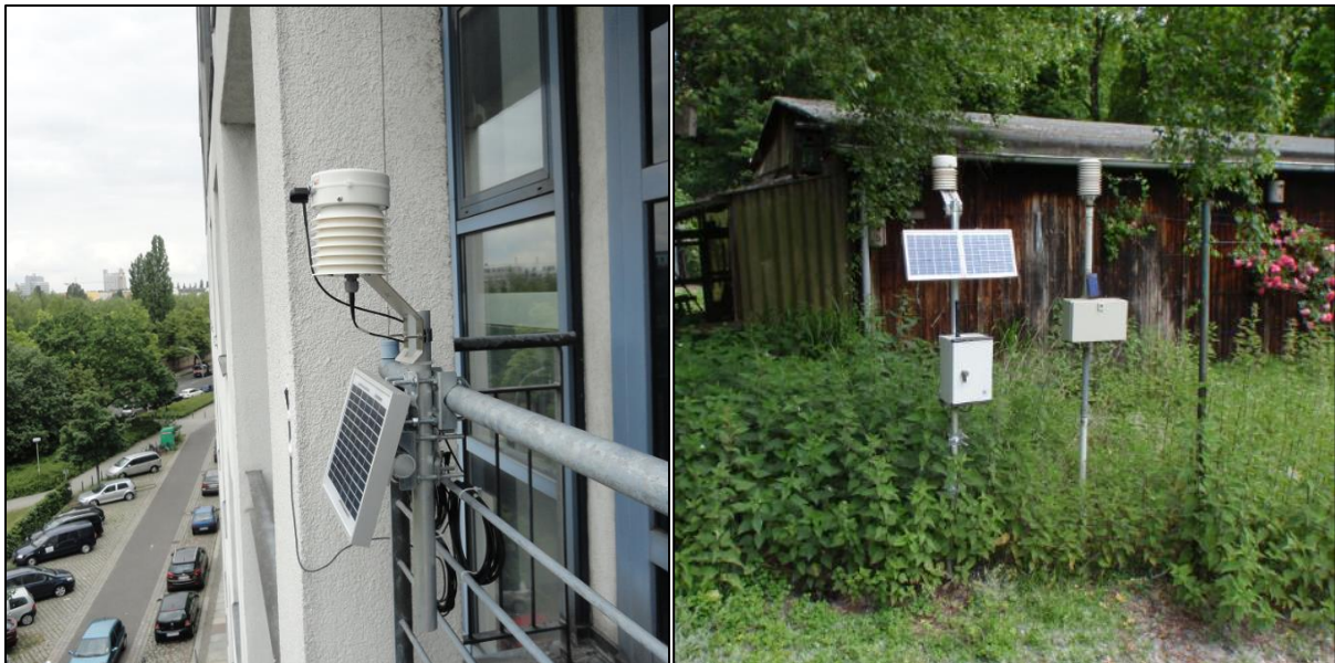
Abb.1 (links): Fassaden-Messstation am Lazarus Pflegeheim zur Messung der Lufttemperatur und Luftfeuchte in einem weißen Strahlenschutzgehäuse, der Oberflächentemperatur (Sensor an der Fassade) sowie der solaren Einstrahlung (schwarzer Sensor am Kopf des Strahlenschutzgehäuses). © Fachgebiet Klimatologie, Technische Universität Berlin.
